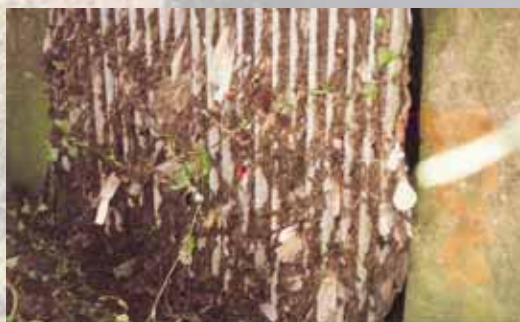
Een overstort heeft gewerkt, dit rooster spreekt boekdelen.
